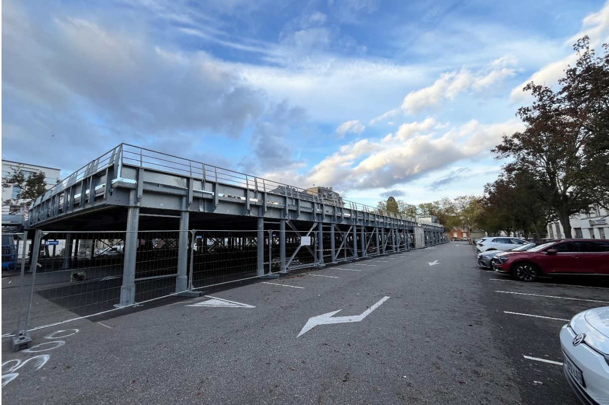
Les travaux d'extension du parking Porte Haute sont en cours et devraient s'achever le 21 novembre.
